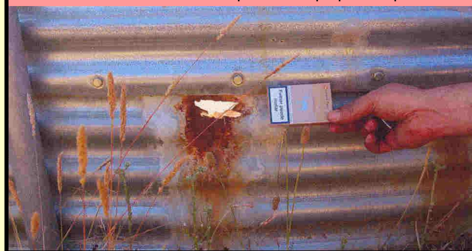
Forat en la banda baixa d'un dipòsit de xapa produït per corrosió
